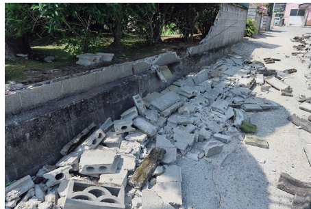
Dinding beton runtuh (sumber: Institut Sistem Pencegahan Bencana)
