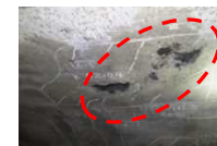
白髪隧道 覆工の剥離
