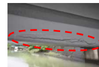
松田川橋 主桁のひび割れ
