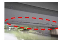
松田川橋 主桁のひび割れ
