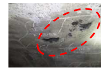
白髪隧道 覆工の剥離
