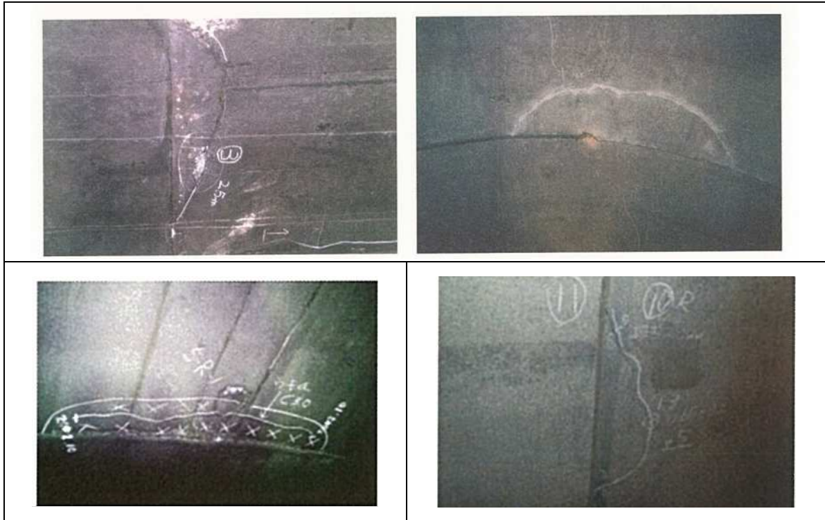
写真 1.1 横断目地の天端付近に発生した半月状のひび割れの例 (P.40 文献 2) 参照)
