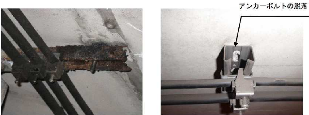
写真 1.13 固定金具の腐食とアンカーボルトの脱落の例（P.40 文献 2) 参照）
