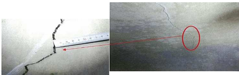
写真 1.5 覆工スパンの中間付近に発生したひび割れの例（P.40 文献 2) 参照）
