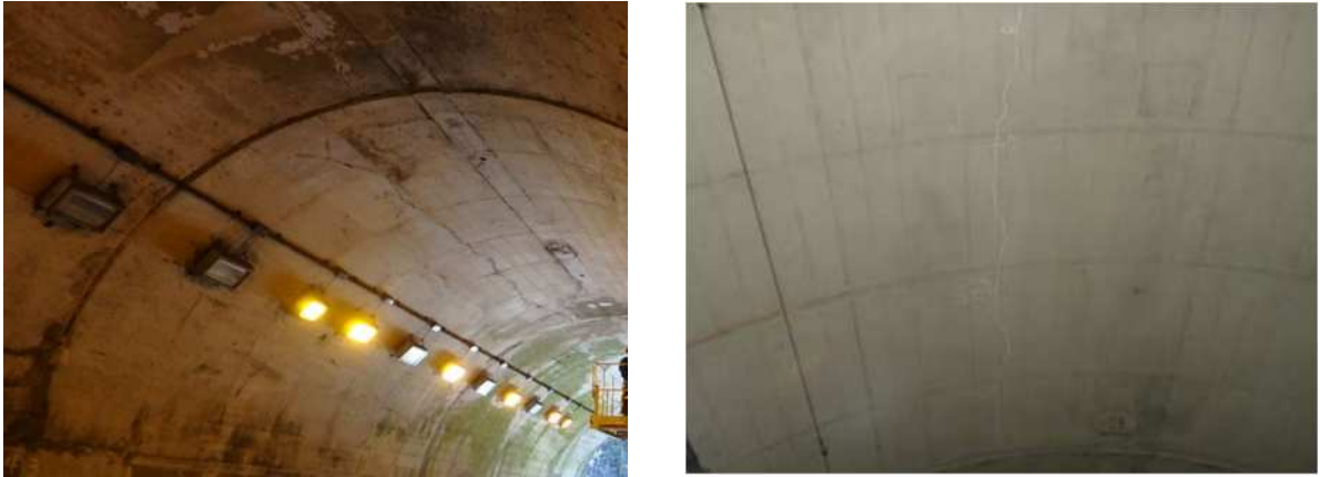
写真 1.4 覆工の天端付近に発生した縦断方向のひび割れの例（P.40 文献 2) 参照）
