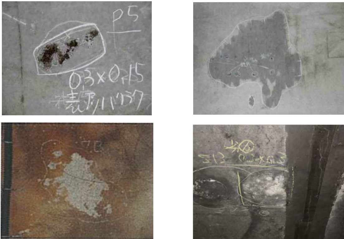
写真 1.7 覆工コンクリートが変色している例 (P.40 文献 2) 参照)
