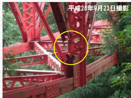
終点側（北川村）上流側の 斜材破断状況の拡大写真
