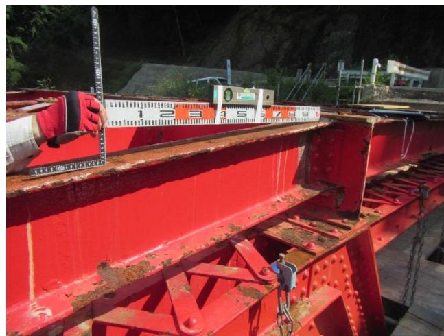
主桁の変形調査
