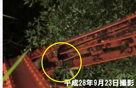
終点側（北川村）上流側の破断面
