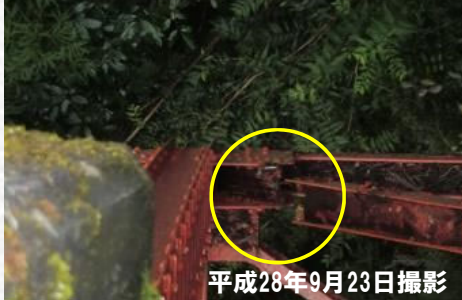
起点側（馬路村）下流側の破断面
