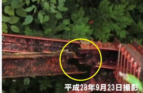
起点側（馬路村）上流側の破断面
