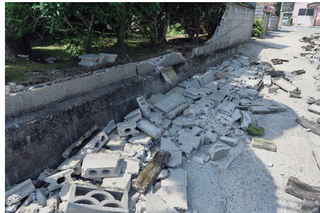
Sập tường ngăn (Cung cấp bởi Viện nghiên cứu hệ thống phòng chống thiên tai)
