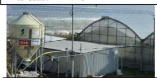
温浴施設用ペレットボイラー （実証データ）
