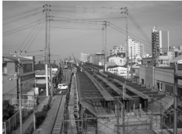
ハイポールの状況 (県道高知本山線 旧愛宕町踏切付近)
