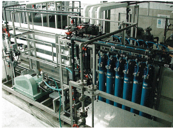
図2 プラント (UF/ROユニット)
