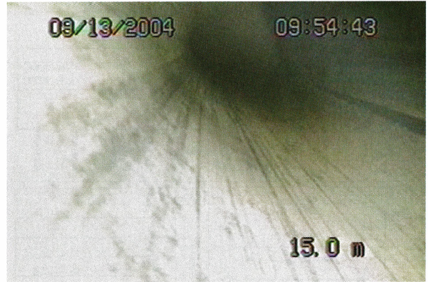
図3-b 深層水取水管内壁 (PE管部)
