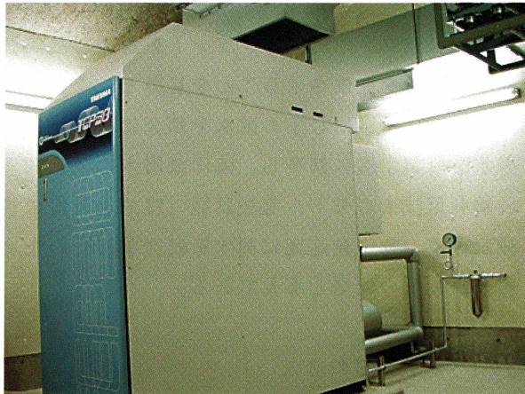
TCP30 (後：燃料パイプと給湯管 上：給気ダクト)
