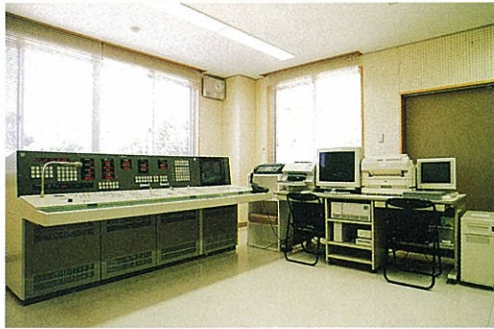
操作卓および情報処理装置
