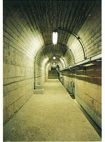
監査廊内部と地震計
