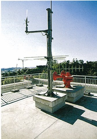
テレメータ設備および警報サイレン
