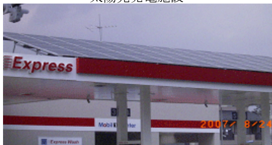
太陽光発電施設
