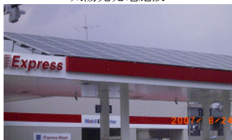
太陽光発電施設
