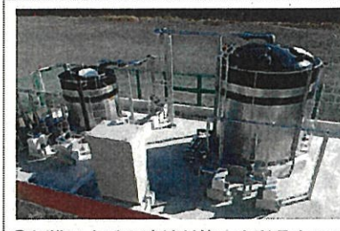
⑨相模川水系上流域対策 山梨県内の下水処理場に新たに設置したリンを取り除くための設備を稼動した。(山梨県 桂川清流センター)
