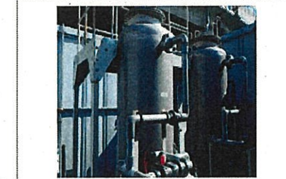
⑦地下水保全対策 有機塩素系化学物質により汚染された地下水を施設の装置に通すことにより水質浄化を図った。(秦野市)
