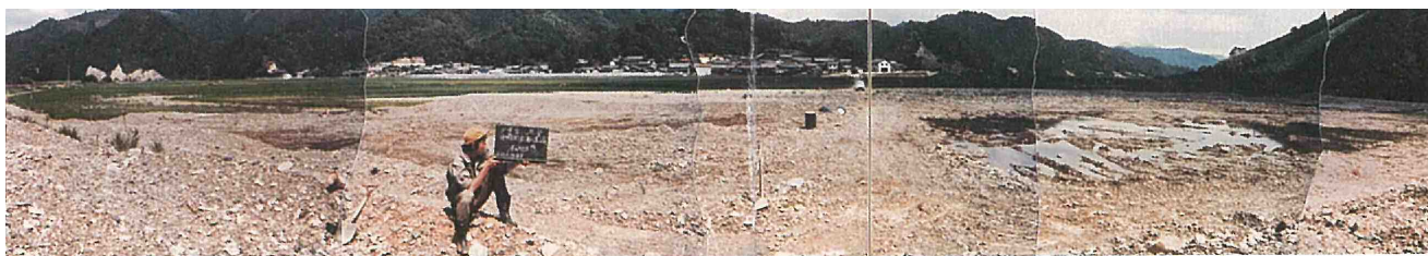
中角地区右岸堤防の決壊
