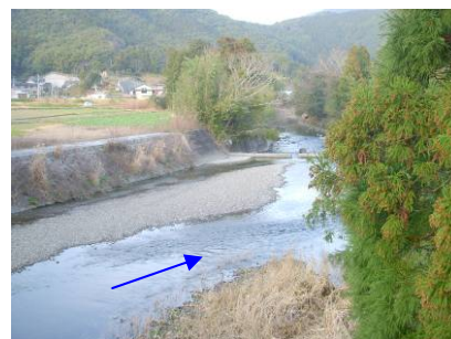
被災箇所の現在の状況
