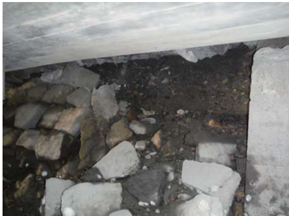
写真②石積護岸の崩壊状況
