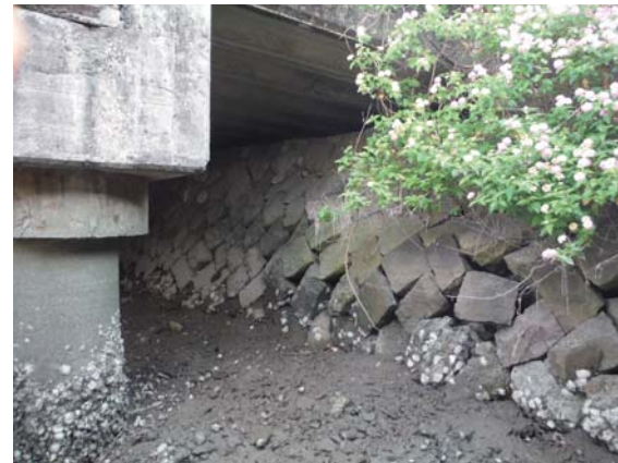
写真③石積護岸のはらみ状況
