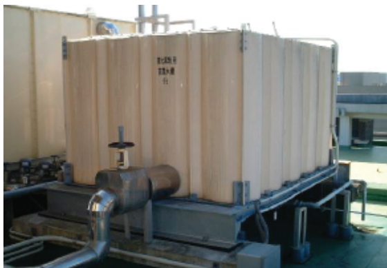
雨水利用高架水槽（本庁舎屋上）
