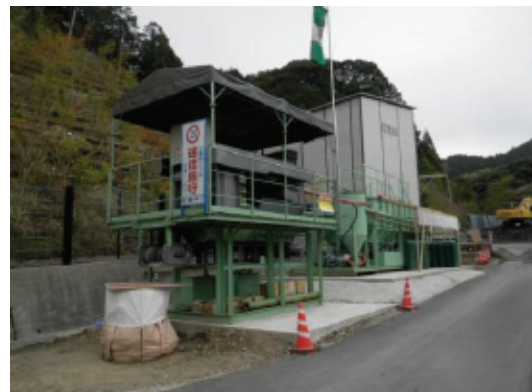
(写真6) 濁水処理プラント
