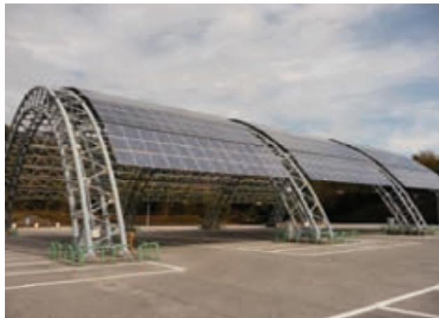
太陽光発電システム (のいち動物公園)
