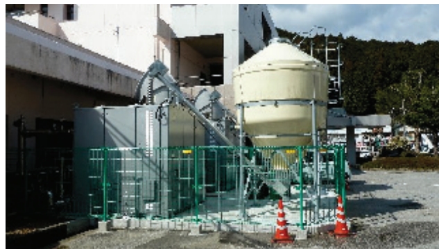
佐川庁舎木質ペレット冷暖房システム (佐川町甲)
