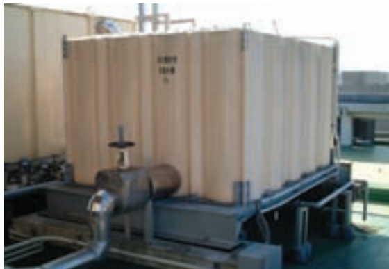
雨水利用高架水槽（本庁舎屋上）
