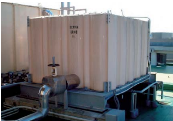
雨水利用高架水槽 (本庁舎屋上)
