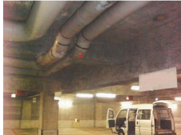
建物の天井に吹き付けられたアスベスト (吹き付けロックウール：飛散性)
