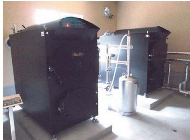
温泉施設の薪ボイラー（いの町 土佐和紙工芸村くらうど）
