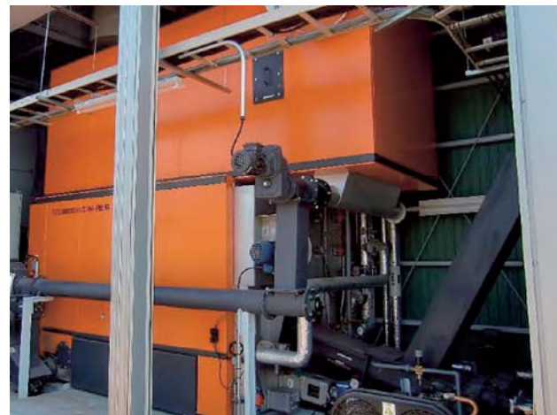
観光農園のハウス加温用チップボイラー （南国市 西島園芸団地）
