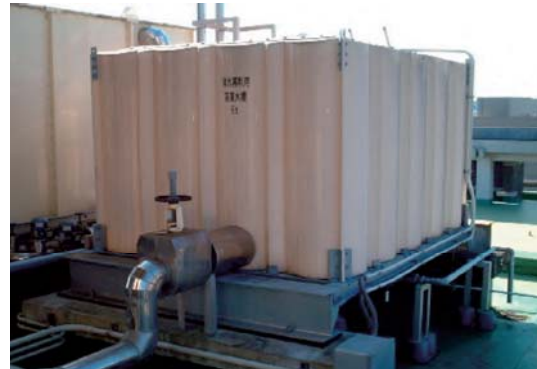
雨水利用高架水槽(本庁舎屋上)
