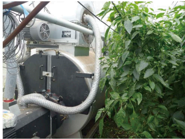
施設園芸加温用ペレットボイラー(四万十町興津)
