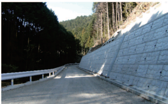
（写真6）施工後:河川に道路構造物が入らないように道路法線を設定
