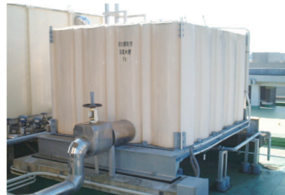
雨水利用高架水槽（本庁舎屋上）
