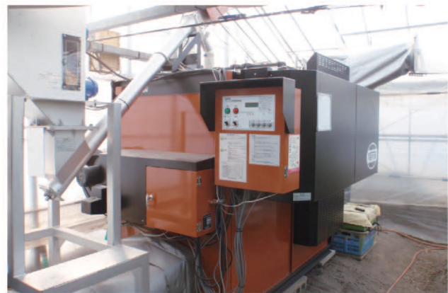
木質ペレットボイラー(安芸市)
