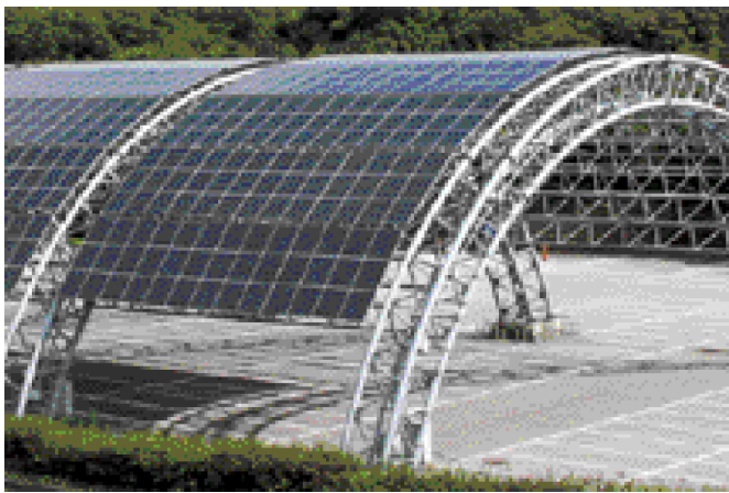
太陽光発電システム (のいち動物公園)
