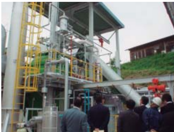
仁淀川町が取り組む木質バイオマス発電の設備
