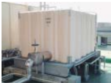
雨水再利用高架水槽(本庁舎屋上)
