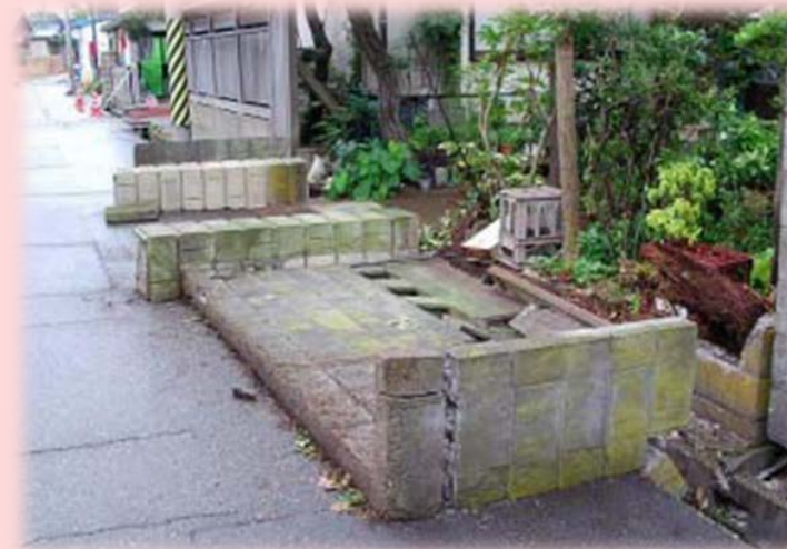
地震により倒壊したブロック塀 （平成19年新潟県中越沖地震）
