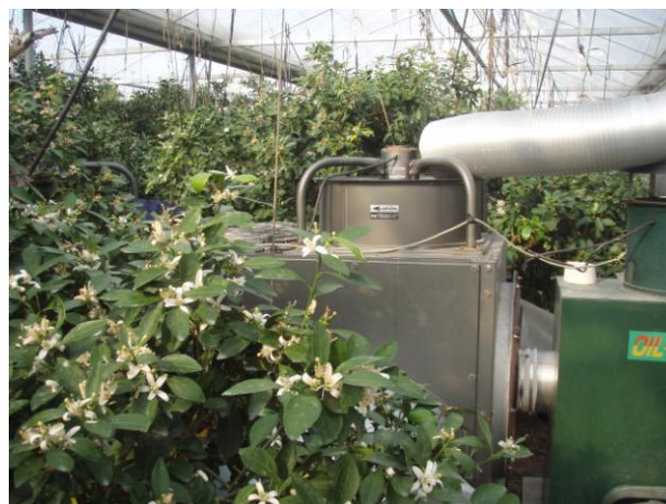
排熱回収装置
