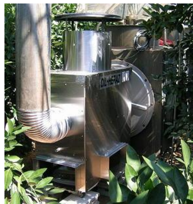
加温用ボイラー 排熱回収装置
