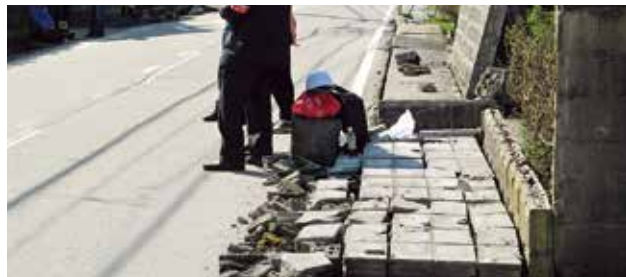
能登半島地震 倒壊したブロック塀=石川県輪島市（平成19年3月26日／提供：一般財団法人 消防科学総合センター）
