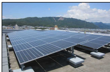
県安芸総合庁舎屋上に設置した太陽光発電設備
