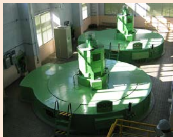
永瀬発電所 発電機
