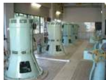
送水ポンプ場
