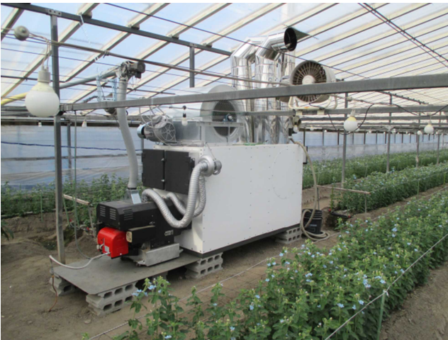
木質ペレットボイラー（芸西村）
