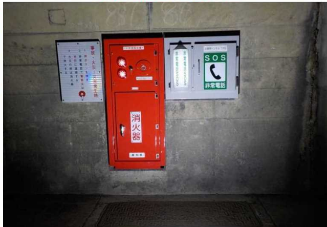
押しボタン式通報装置・非常電話機(坑内R側)
