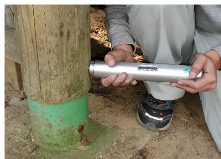
図2 腐朽劣化状況調査(ピロディン)
