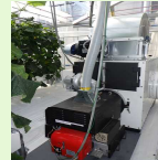
木質ペレットボイラー
