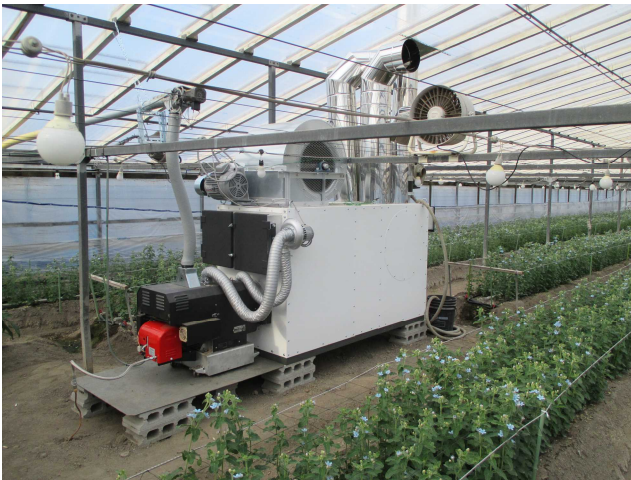
木質ペレットボイラー (芸西村)
