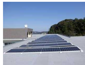
事業所に設置された太陽光発電設備
