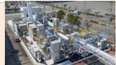
神戸市のポートアイランドに整備された水素発電施設（水素CGS）
