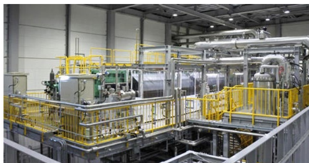
10MWの水電解装置
