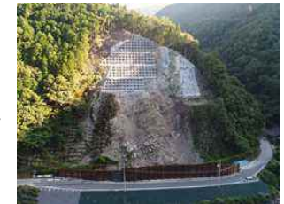
安田東洋線（安田町平瀬地区）
