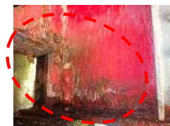
新大森橋の損傷状況
