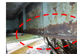
美舞橋の損傷状況
