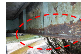
美舞橋の損傷状況
