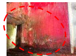
新大森橋の損傷状況
