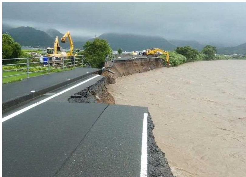
安芸市 安芸川の増水で崩落した堤防と県道
