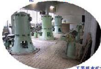
工業用水ポンプ場
