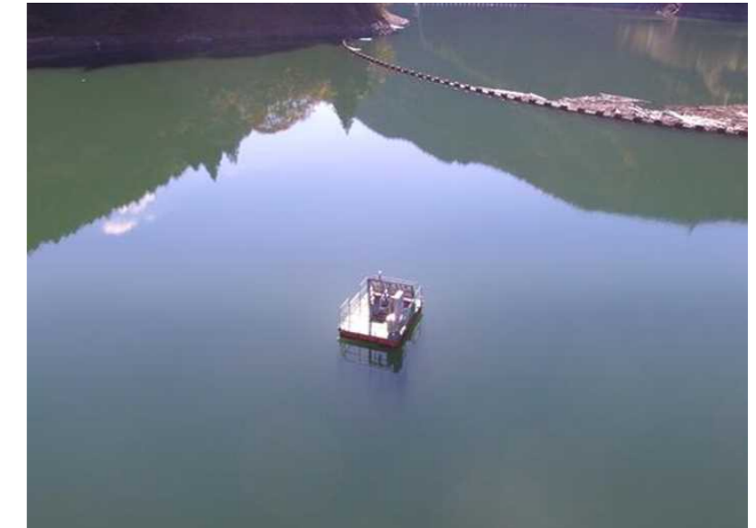
▲自動濁度計 全景
