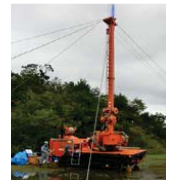
(タワーヤード)
